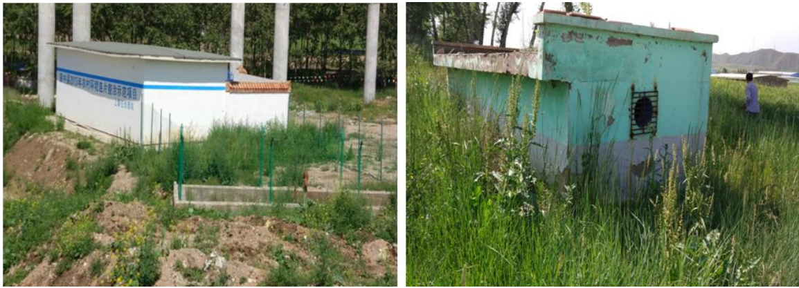
图 2-3 湟中农村生活污水处理站现状
