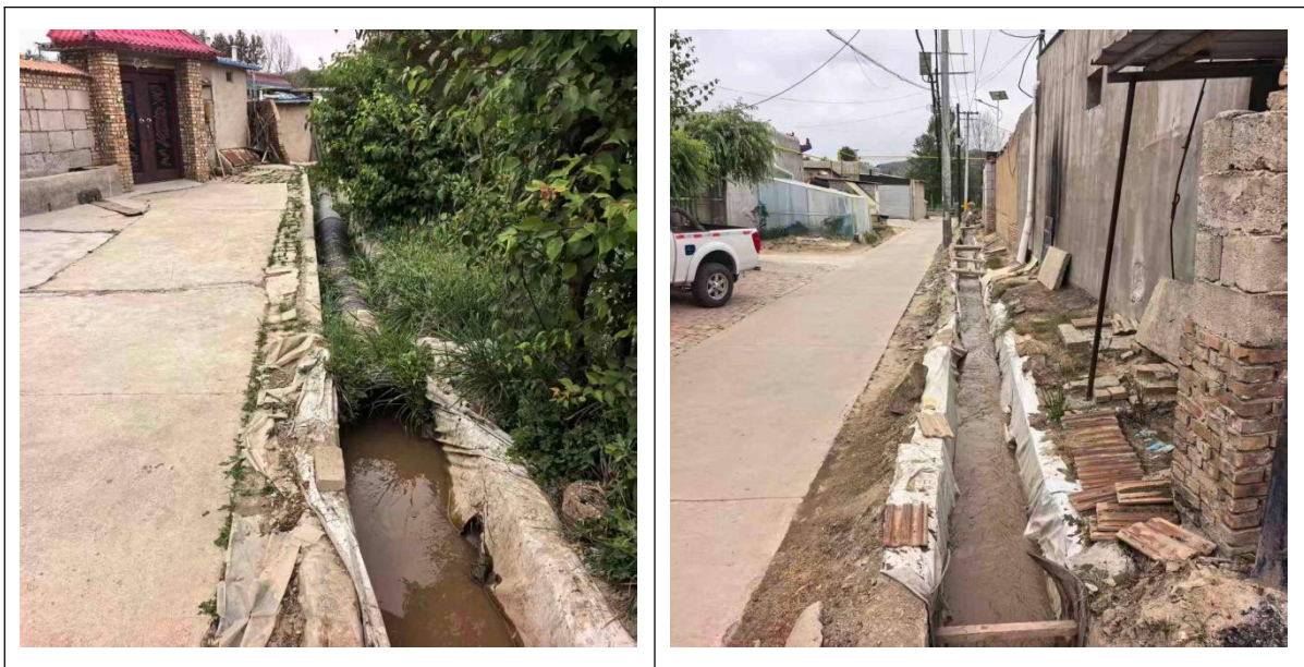
云谷川灌区（陈家庄支渠渗漏严重）
