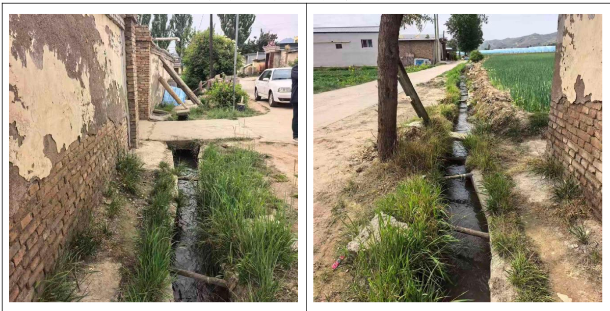
拦隆口灌区（千西支渠倒塌严重）
