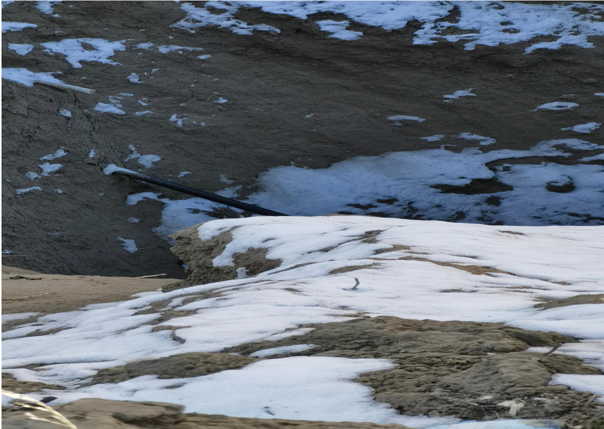
海子沟乡薛姓庄村供水管裸露
