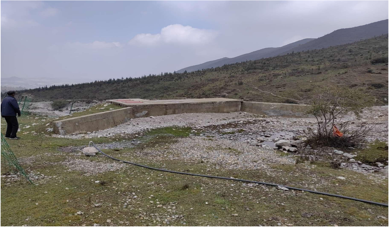
原村庄引水口运行良好
