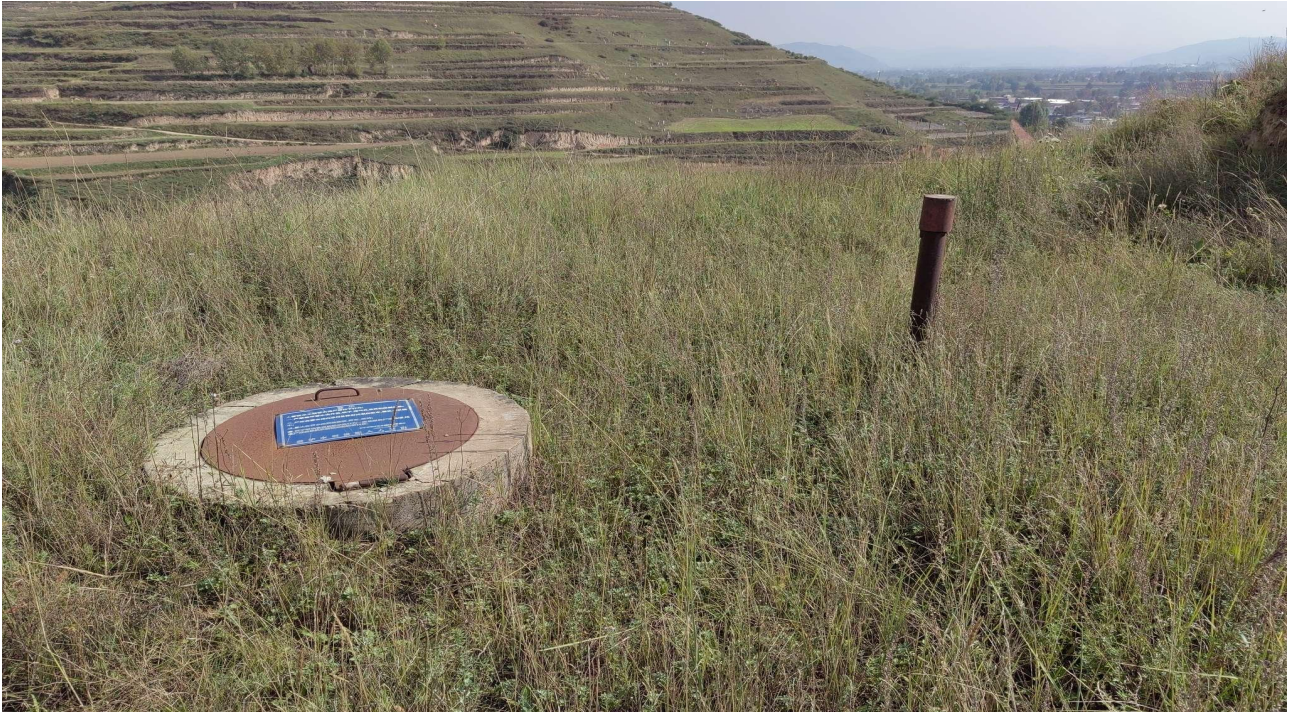
拦隆口村 200t 蓄水池
