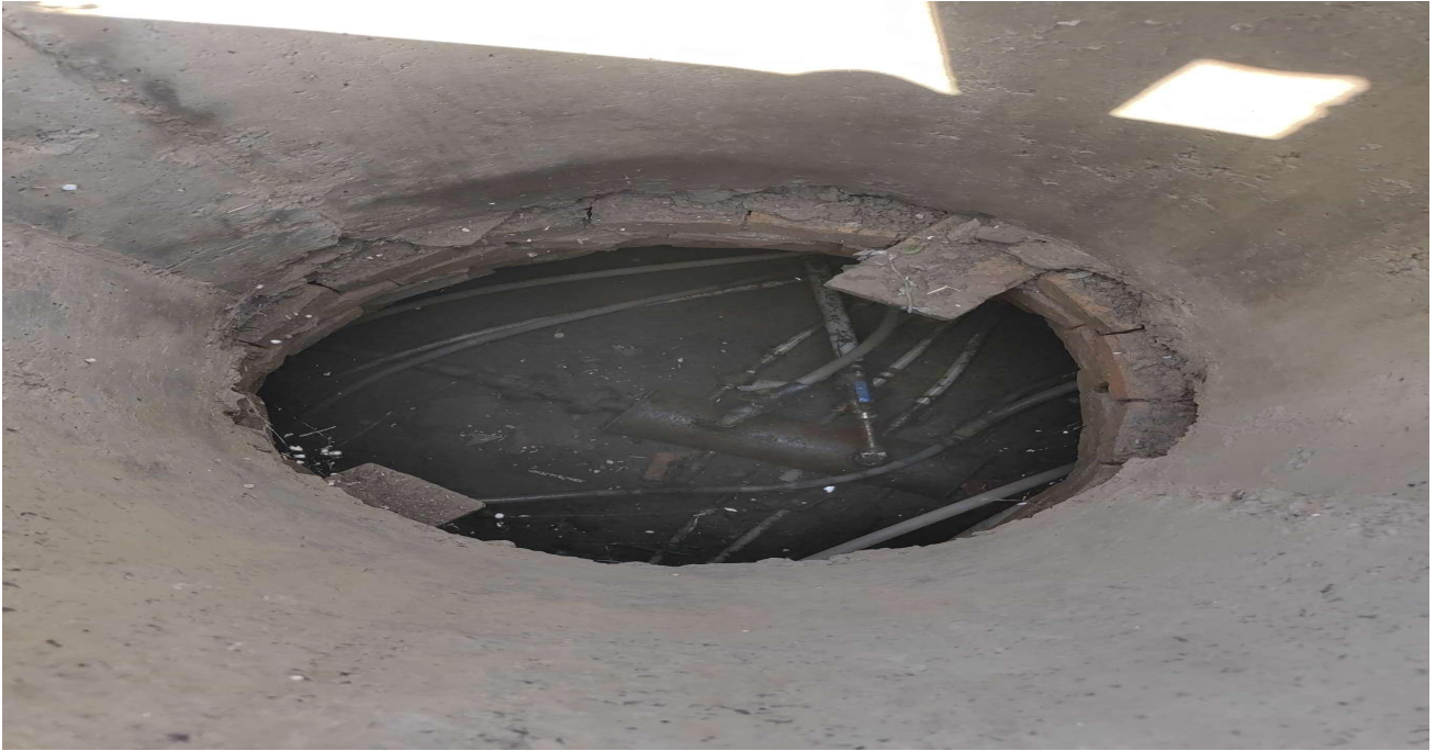
已建井现状情况
