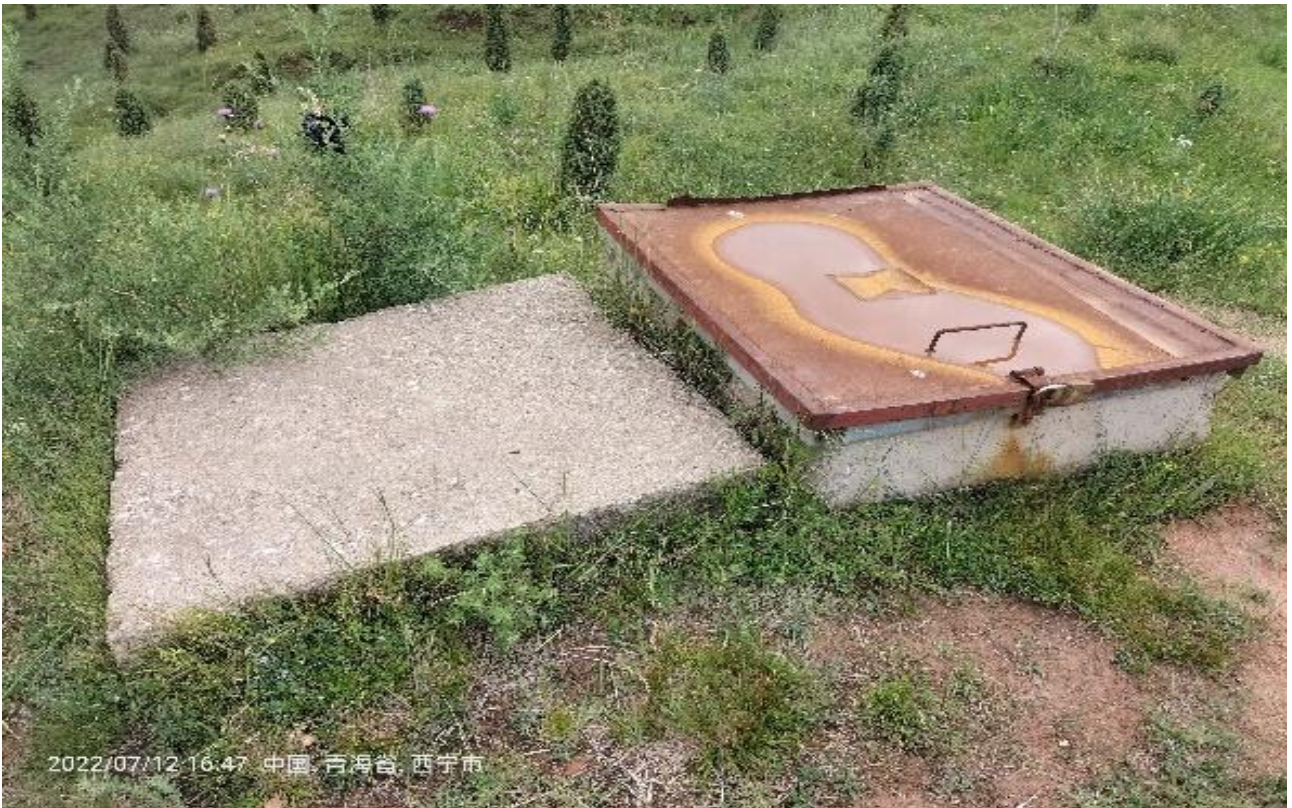
红崖沟村已建蓄水池目前运行良好
