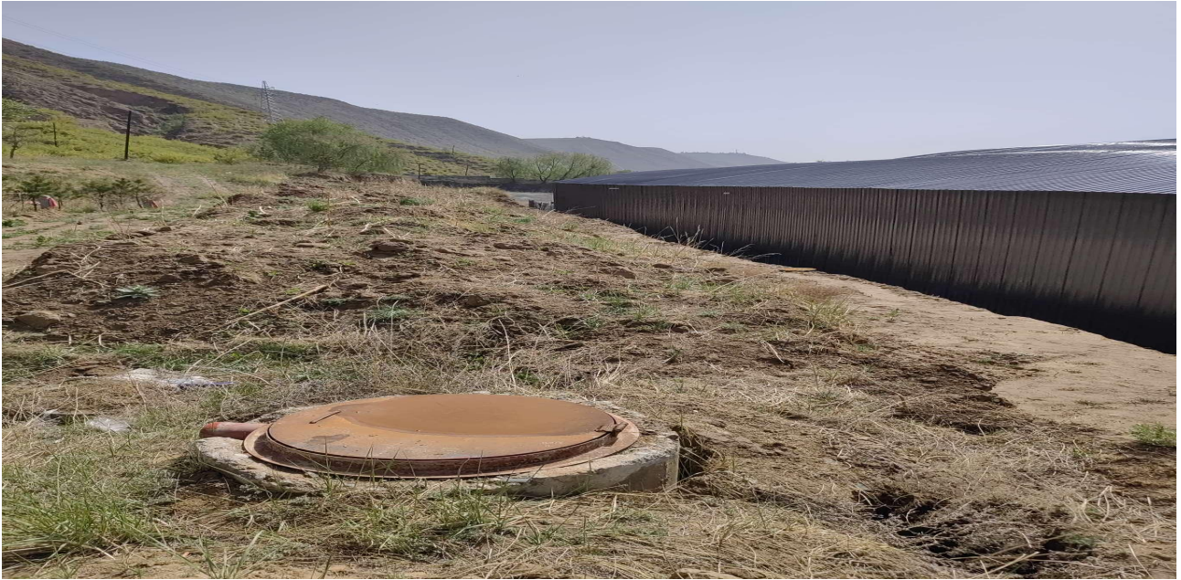
已建管网阀门井现状
